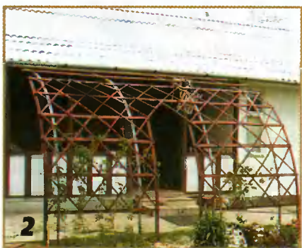
Каркас навеса уже покрашен, но ещё без крыши. Вдоль навеса высажены кусты дикого винограда.
